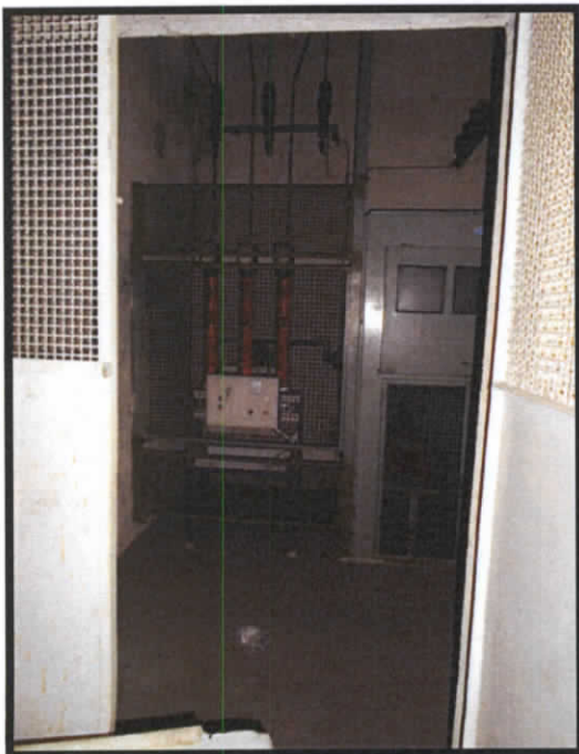
Figura 26 - CASA DE FORÇA
