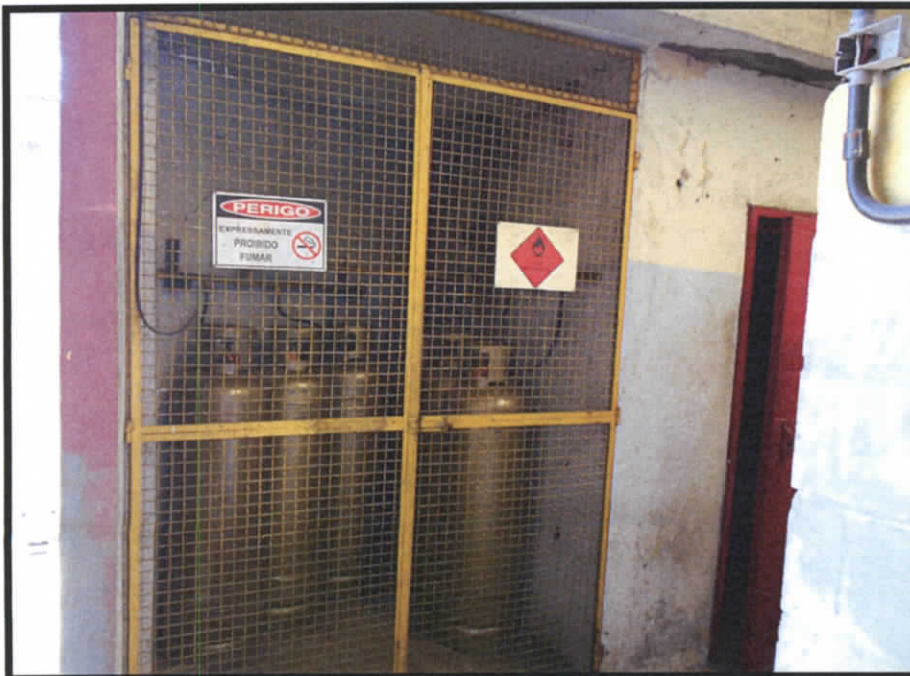
Figura 24 - CASA DE INSTALAÇÃO DE GÁS COM 06 BOTIÕES
